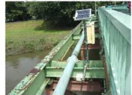
【超音波式水位計設置例2】
