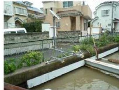
【超音波式水位計設置例1】
