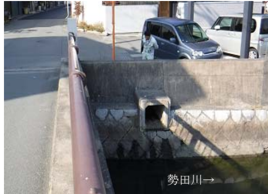
5 6 図 2-5 逆流防止フラップ弁設置予定の排水管
