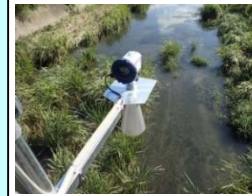
危機管理型水位計の設置（三重県）
