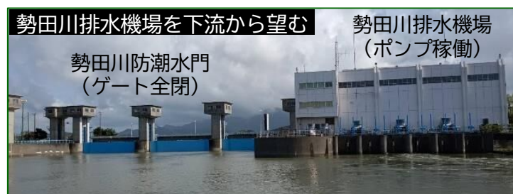
<河川管理施設の稼働状況>
