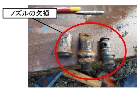
ノズル(ウォータージェット)の変状
