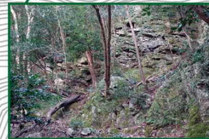
落石となって崩落する可能性のある岩
