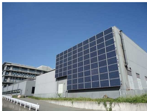
太陽光発電設備
