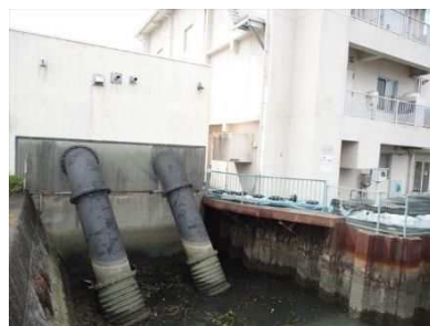
有連ポンプ場
