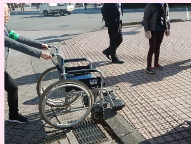
写真：歩道の段差
