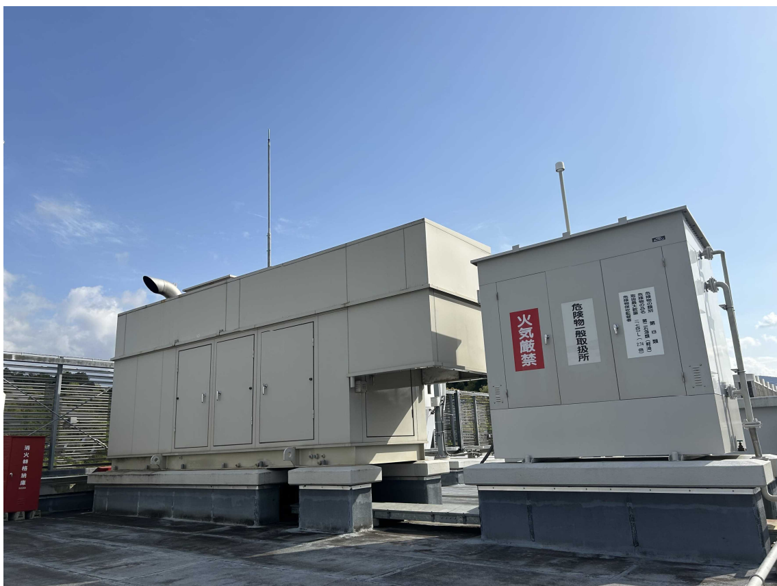
危険物施設 一般取扱所（発電設備）
