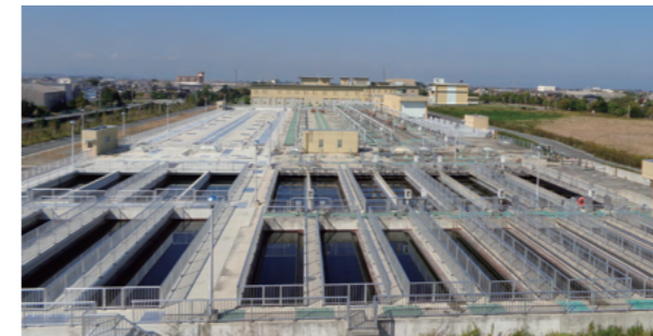
宮川浄化センター(大湊町) 1日最大処理水量 53,700m 3 (全体計画)
