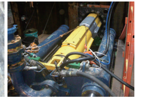
機械で横穴を掘っている様子 (地下深くに下水道管を埋める工事)
