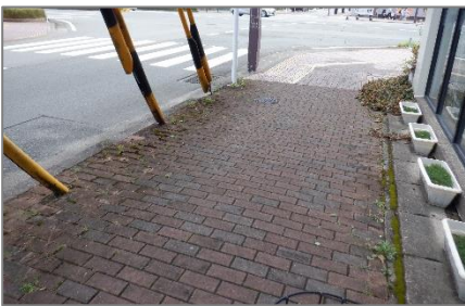
視覚障がい者誘導用ブロック未整備（右図③）
