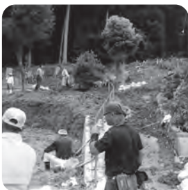
土砂の撤去の様子 (丹波市豪雨災害)
