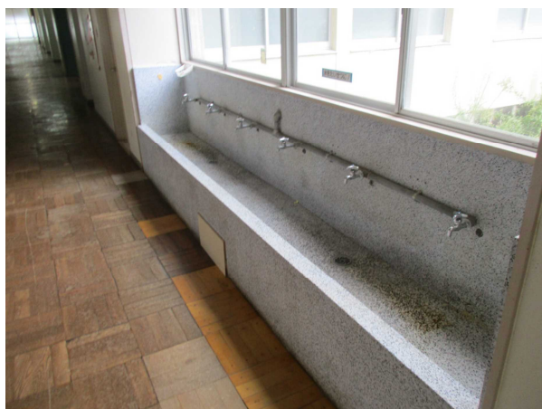
校舎1階 手洗い場
