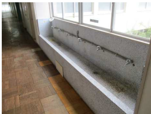
校舎1階 手洗い場
