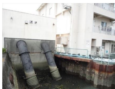
有蓮ポンプ場
