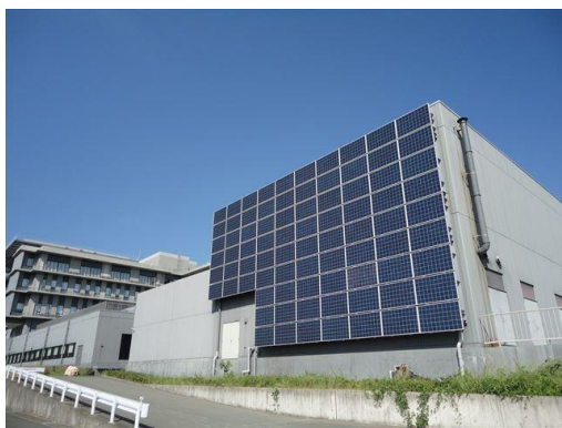
太陽光発電設備
