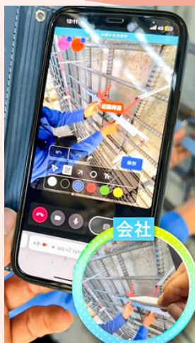
(写真2)スマホを使った配筋の遠隔確認。操作も直感的にでき、現場の情報も伝えやすい。
