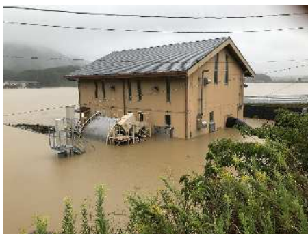
浸水した排水機場(R1.10台風19号)
