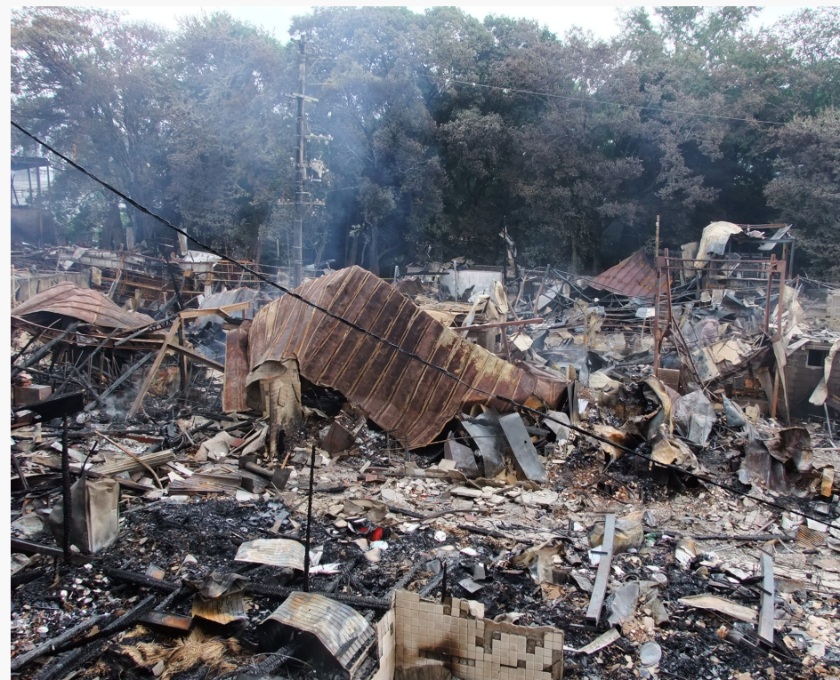
焼損区域の様子
